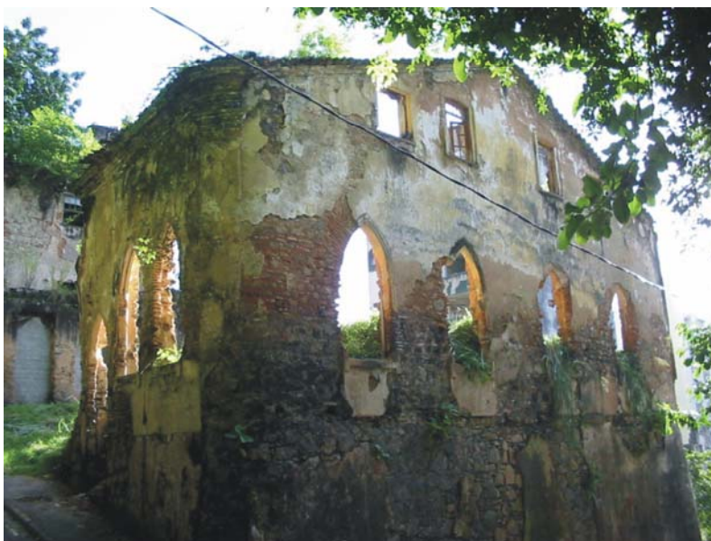
Edificación arruinada en lo centro histórico de la ciudad de Salvador de Bahia. Fotografía: Ricardo Borges, 2005
